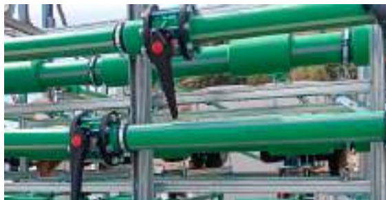
Instalación ACS, España. / ACS installation, Spain.
